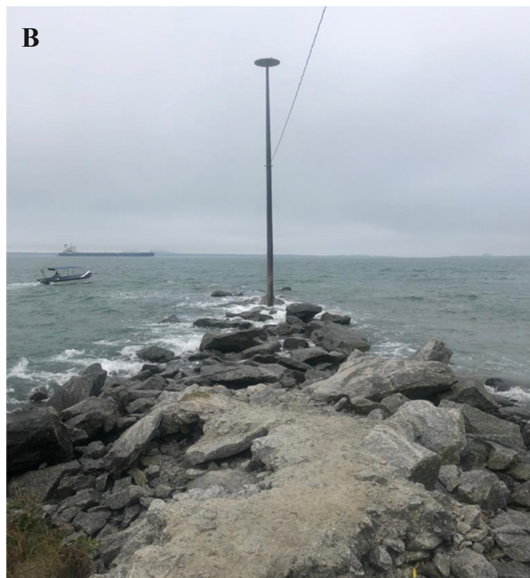
Figura 2. (A) Estruturas presentes na desembocadura do Canal do DNOS, sendo o molhe à direita do canal (Pontal I) com 107 m e o guia corrente ao lado esquerdo (Pontal II) com 170 m. (B) Atual condição do molhe na margem direita da desembocadura do canal do DNOS (2020), com perda do material fino e galgamento em parte da estrutura devido à alteração de maré.
